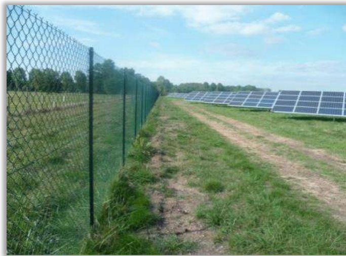
Mise en place de la clôture : pose des ancrages, des piquets et du maillage
