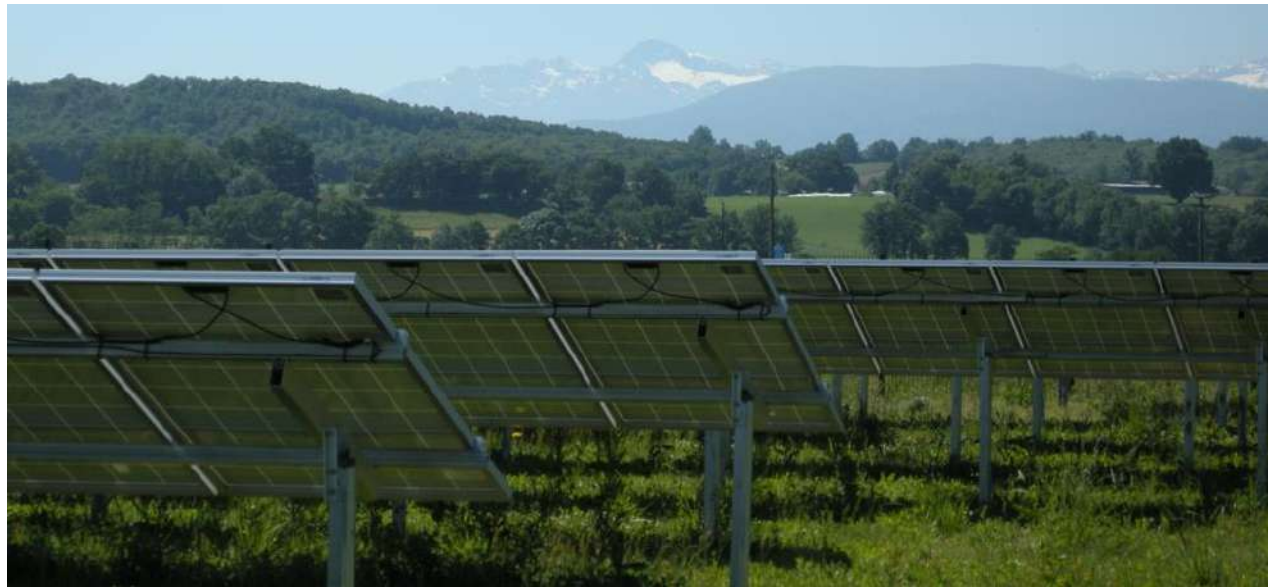
Parc solaire photovoltaïque de Saint-Martory (31)
