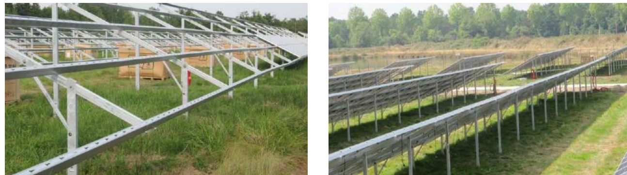
Impacts faibles sur un terrain humide suite à la pose des structures et modules - Source : LUXEL, 2013
